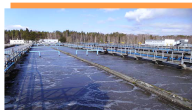
Аэротенки биологической очистки на очистных сооружениях канализации в г. Череповце после модернизации воздуховдного и насосного оборудования
