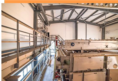
Цех механического обезвоживания осадка на очистной водопроводной станции «Заовражная» в г. Чебоксары, 2016 год
