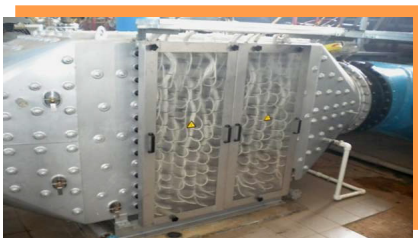
Установки обеззараживания воды ультрафиолетовым излучением в г. Набережные Челны
