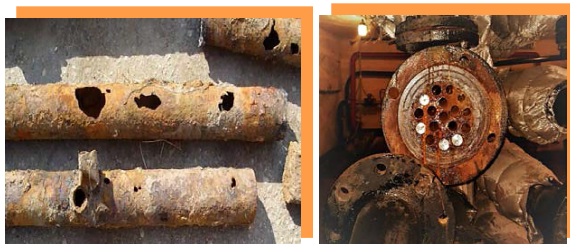
Изношенность оборудования ЦТП и труб горячего водоснабжения (кислородная коррозия) в г. Казани к моменту начала реализации проекта
