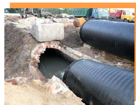
Замена трубы канализационного коллектора в г. Волжском путём протаскивания внутрь старого свода без раскопки траншеи
