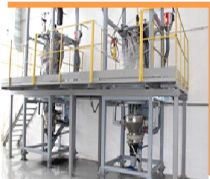
Станция углеродирования воды в г. Набережные Челны
