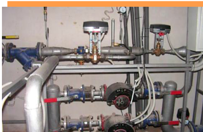
Оборудование ИТП, установленное в многоквартирном доме в г. Братске
