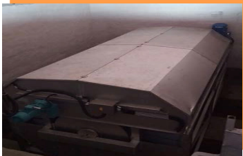
Дисковый микрофильтр с мембраной 10 мкм для фильтрации воды на сооружениях водоподготовки в г. Череповце
