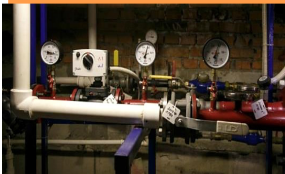
Индивидуальный тепловой пункт с погодным регулированием в многоквартирном доме, управление которым осуществляет ТСЖ «Кордон» 9 (г. Казань, ул. Батыршина, д. 33)
