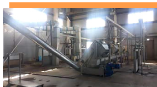
Оборудование для механической очистки стоков, установленное в здании решёток биологических очистных сооружений в г. Волжском
