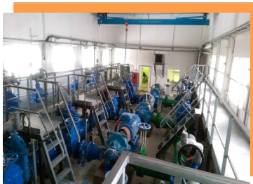
Насосная станция третьего подъёма на водозаборе в пос. Скуратовский г. Тулы
