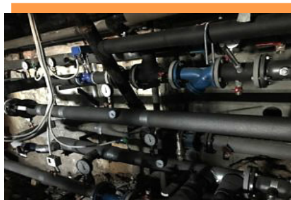
Тепловой узел с системой автоматического годового регулирования, установленный в ходе капитального ремонта в многоквартирном доме № 98 по набережной Северной Двины в г. Архангельске
